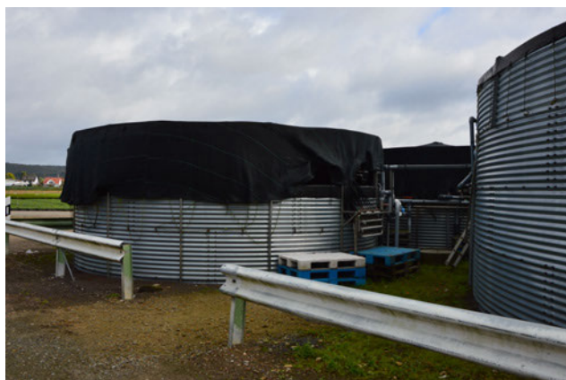
Fot. 38. Spowolniony filtr piaskowy wykonany z blachy falistej. (W. Treder)
