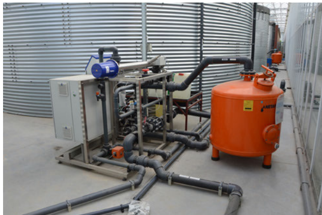
Fot. 39. Skomputeryzowany system sterylizacji wody za pomocą promieniowania UV-C. (W. Treder)
