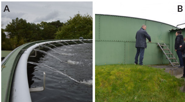
Fot. 37. Spowolniony filtr piaskowy (A) wykonany z płyt stalowych (B). (W. Treder)
