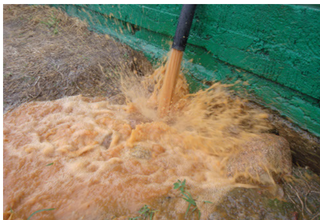
Fot. 35. Wodorotlenek żelaza wymywany ze złoża podczas płukania filtra piaskowego. (W. Treder)
