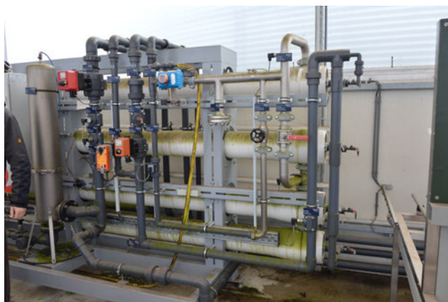
Fot. 36. Filtr odwróconej osmozy. (W. Treder)
