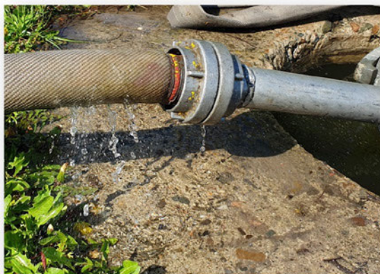
Fot. 66. Taki „niewinny” przeciek w skali sezonu jest przyczyną bardzo dużych strat wody. (W. Treder)
