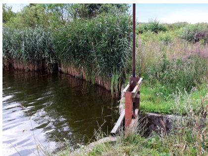
Zastawka piętrząca na rowie melioracyjnym (fot. P. Nawala)
