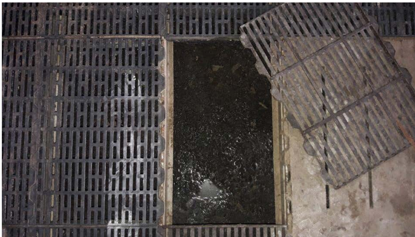
Fot. 5.5. Zbiornik gnojowicy pod rusztami (autor: K. Bąk)
