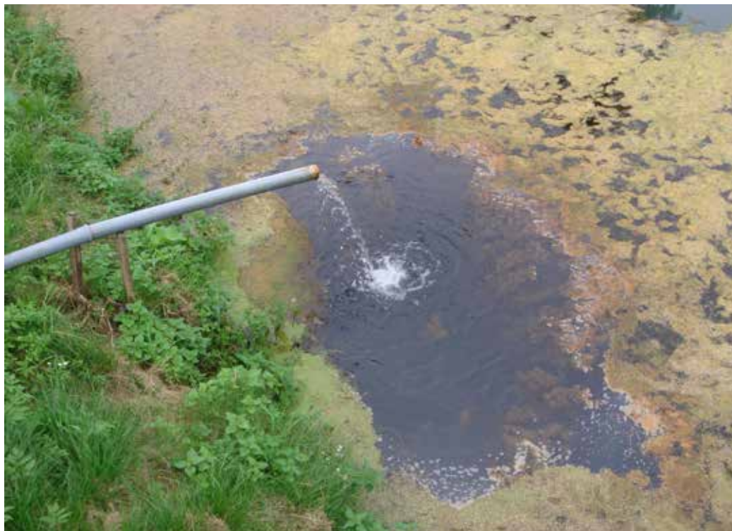
Fot. 12. Zakwit glonów w zbiorniku retencyjnym
