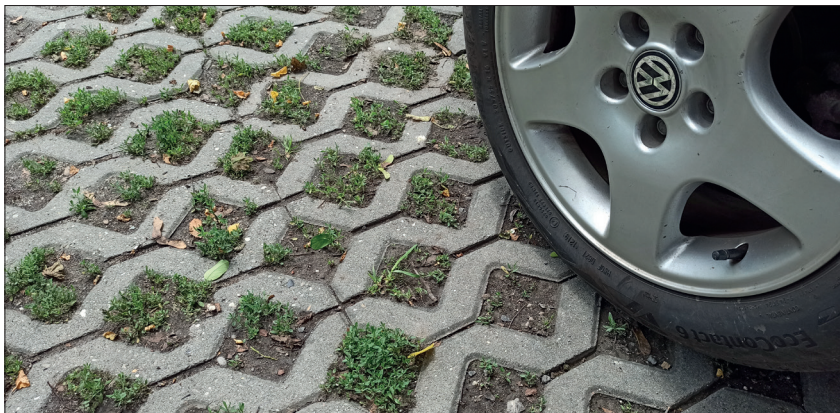
Rys.6. Płyta ażurowa na miejscu postoju samochodów. Widoczna kolmatacja gruntu. W tym miejscu wystąpiła ona już po 3 latach od budowy Fot. T. Ciesielczuk
