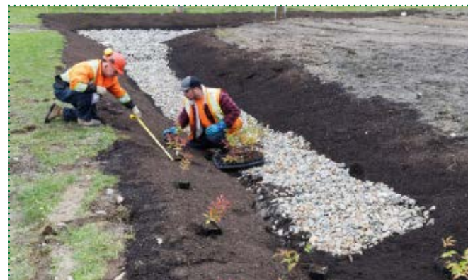
Fot. 17. Warstwa filtrująca to podstawowy element ogrodu deszczowego
