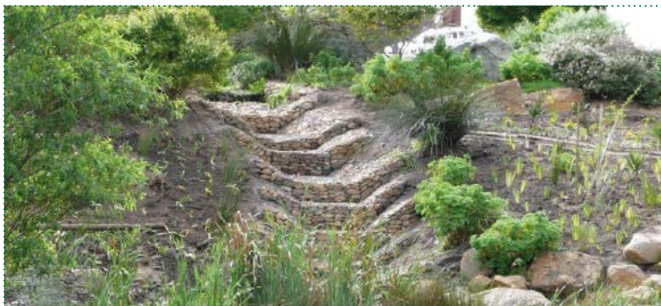
Fot. 3. Płynąca woda lepiej wytraca energię na dnie potoku, czy strumienia górskiego pokrytego gabionem, wyraźnie zmniejsza się w ten sposób zagrożenie powodziowe, a zwiększa przesiąk dogłębowy – retencja wody (źródło: www.ecogabion.co.za ) https://www.ecogabion.co.za/resources/gabion-g.JPG
