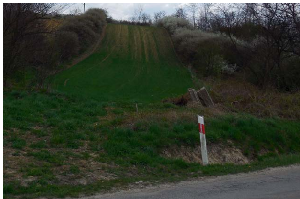
Rysunek 46. Wyraźne zróżnicowanie gęstości ładu. Uprawa wzdłuż stoku spowodował znaczną erozję i utratę próchnicy w górnych partiach zbocza (fot. R. Wawer)
