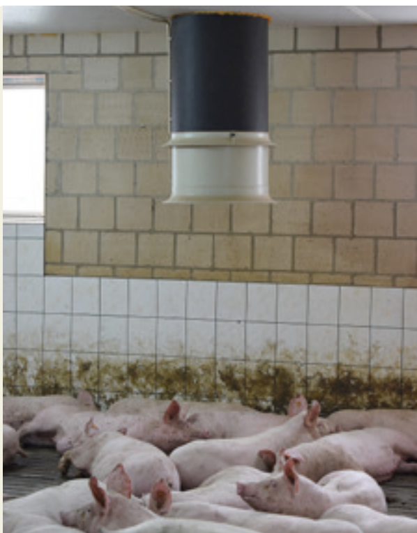
Fotografia 4.3. Wentylacja mechaniczna (fot. A. Dudek)
