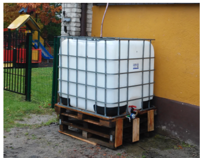
W 2016 roku Klub Gaja przeprowadził modelową akcję oszczędzania wody. W pięciu placówkach oświatowych w Rybniku zainstalowano 1000-litrowe zbiorniki na wodę opadową, którą uczniowie i pracownicy szkół mogą wykorzystywać do podlewania roślin w ogrodzie przyszkolnym, trawników, roślin doniczkowych itp. Na zdjęciu zbiornik w Specjalnym Ośrodku Szkolno-Wychowawczym w Rybniku.
