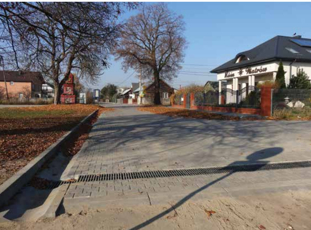
Kratka odpływowa wraz z zainstalowaną w dnie studzienką sedymentacyjną
