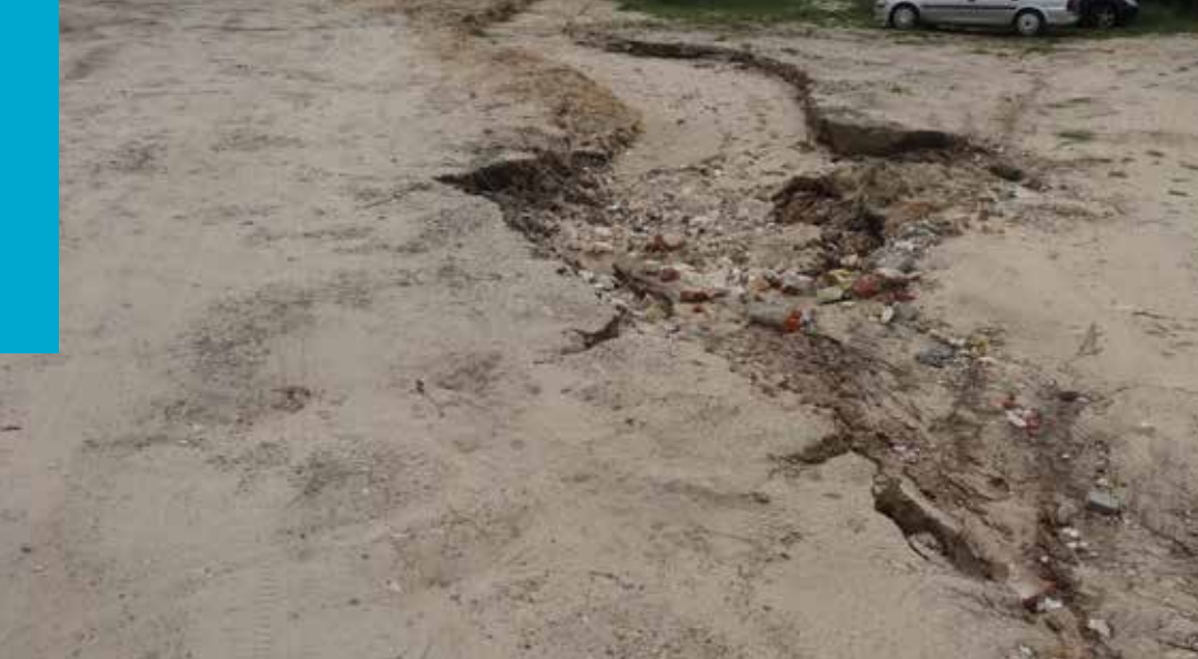
Efekt niekontrolowanego spływu powierzchniowych wód opadowych
